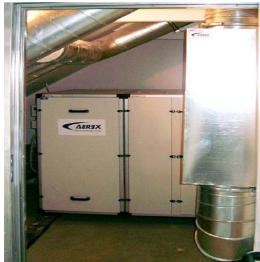
Abb. 5 Lüftungszentrale mit 6 m 2 Nutzfläche
