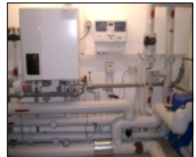
Abb. 11: Kunst am Bau: Dämmung der Leitungen im Heizraum
