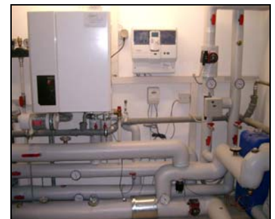
Abb. 11: Kunst am Bau: Dämmung der Leitungen im Heizraum
