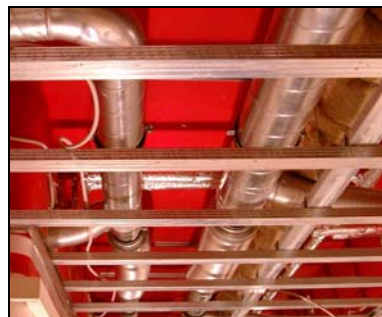
Abb. 10: Lüftungs- und Heizleitungen unter Flurdecke
